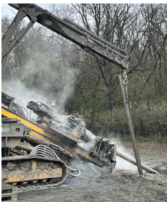
Mittels diesem schweren Gerät werden Bohrungen etwa 30 Meter über dem Tunnel durchgeführt.
